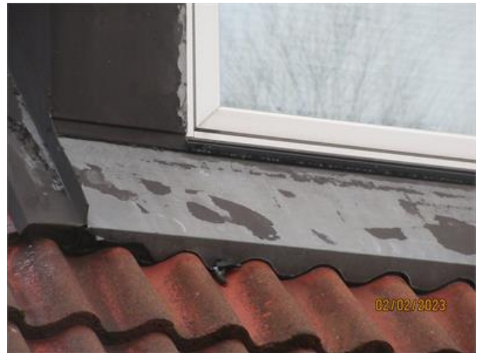
Takkupor i behov av underhåll.
