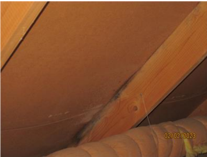
Fuktfläckar förekommer på underlagstak av masonit, vilket är relativt normalt för konstruktionstypen. Fläckarna uttorkade vid besiktningsstillfället.
