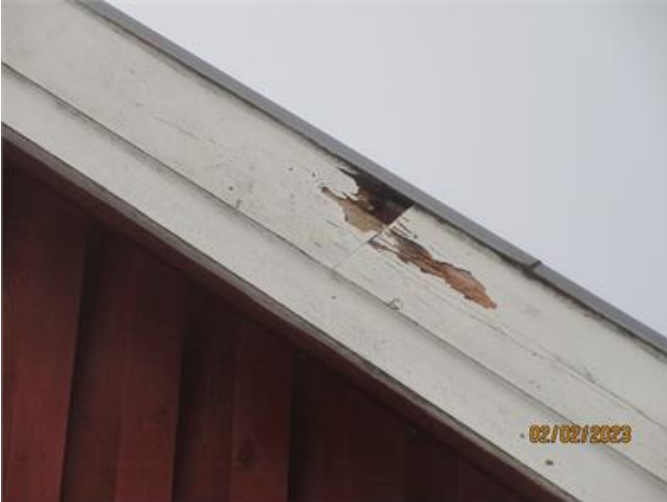
Skador på vindskivor.
