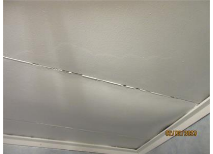
Skada på innertak, vilket bör kontrolleras och åtgärdas i erforderlig omfattning.
