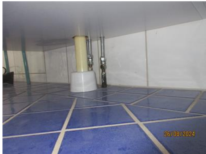
Rör genomföringar i golv.
